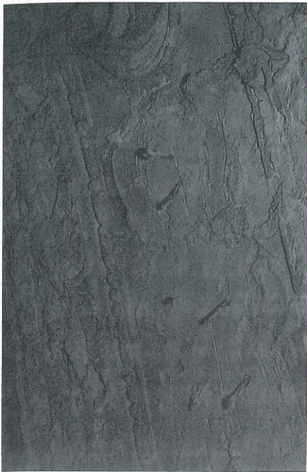
Abb. oben: Residenz, Sala terrena; Gurtbogen mit Verlust des Reliefstuckauftrags; Röt-, Ritzunterzeichnung, Nagelarmierung.
